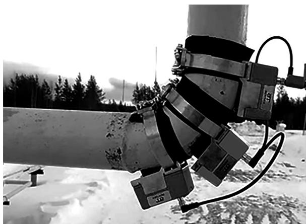
Рис. 13. Датчики, установленные на трубопровод, являющиеся частью системы коррозионного мониторинга
