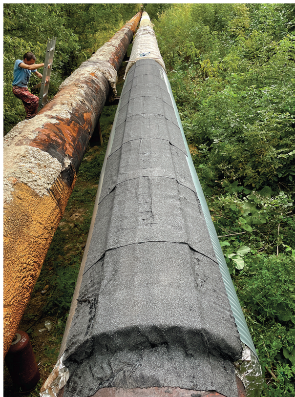
Рис. 1. Трубопровод с поврежденной теплоизоляцией (справа – с защитой от хождения людей)
