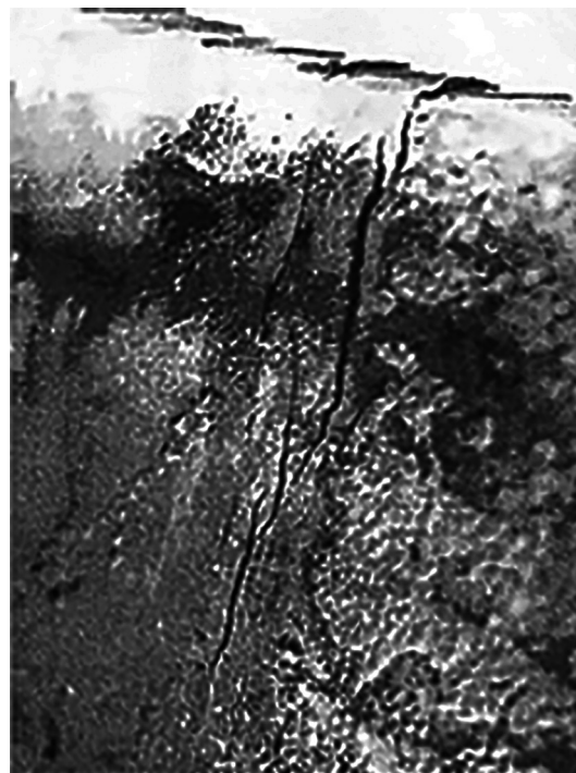
Рис. 5. Трещины в стенке газопровода подземной прокладки
